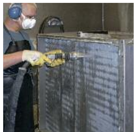
Reinigung eines voll- ständig durch Sand, Schwefel, usw. ver- schlossenen Wärme- tauschers aus der Schlammtrocknung einer Kläranlage
