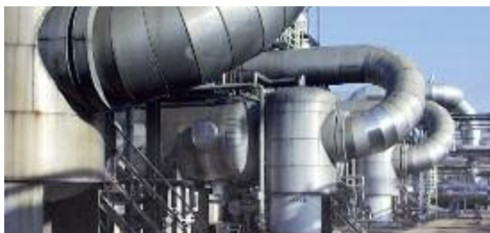
Reinigung Schwefelkondensator in der Gasgewinnung
