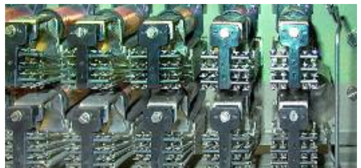
Reinigung einer Relaisstation
