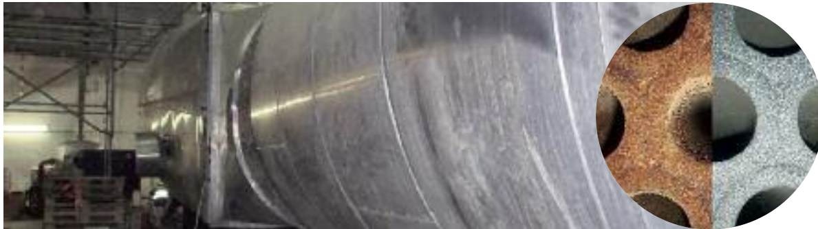
Rohrbündeltauscher eingebaut in die Dampfturbine einer Papierfabrik
